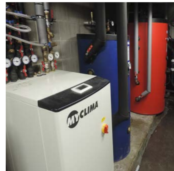
De warmtepomp MyClima 22 kW en twee technische vaten van Fiorini voor het water voor vloerverwarming en -koeling en voor het warme water dat naar de KAMO-satellieten gaat.
