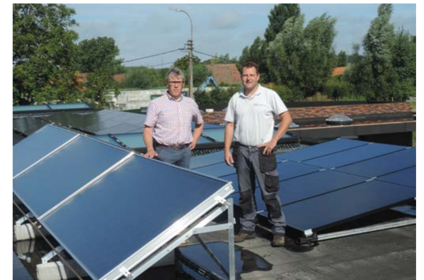
Geert Gallet (Climapac) en Peter Vanbelleghem (Ensol-Tec) tussen de zonnepanelen op het dak.
